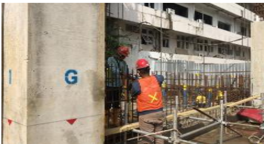
Gambar 3.127 Pekerja Besi Tidak Menggunakan Sarung Tangan
