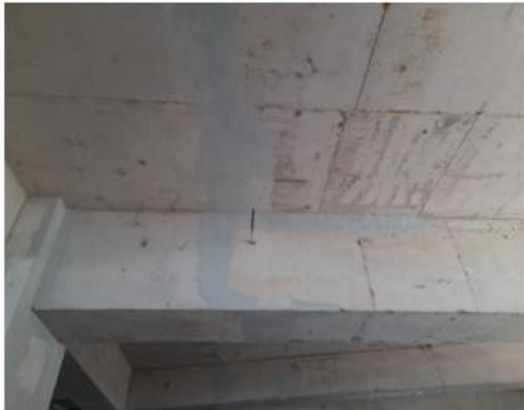
Gambar 3.123 Temuan dan Perbaikan Balok Bunting
