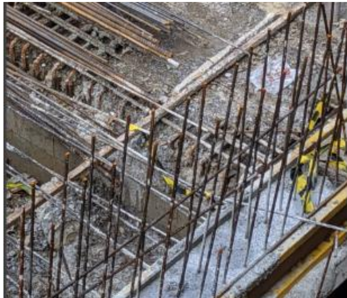
Gambar 3.126 Besi Tulangan Belum Terpasang Rebar Cap
