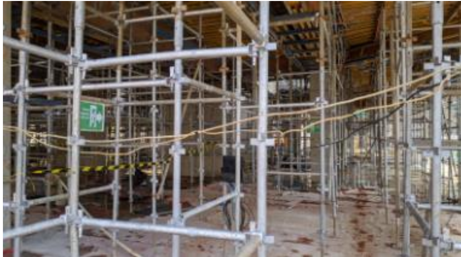
Gambar 3.130 Jalur Evakuasi Terhalang Kabel
