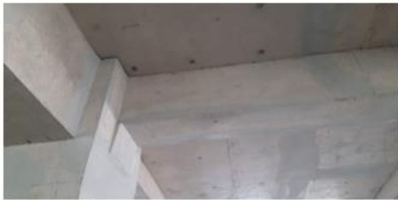
Gambar 3.117 Perbaikan Balok Keropos
